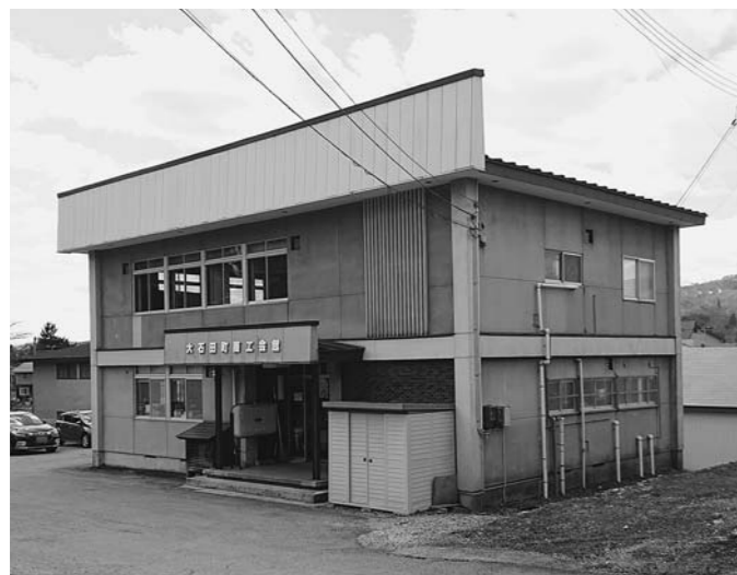
雨漏りもひどい(商工会館)
