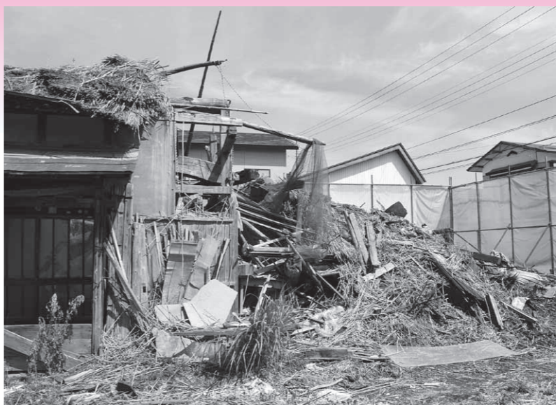
管理も難しくなっていく空き家
