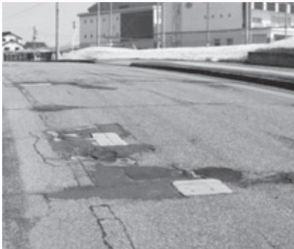
中学校前の道路、早く補修を！
