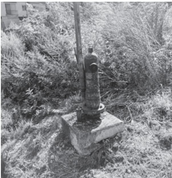
近場にホースのない、野ざらしの消火栓
