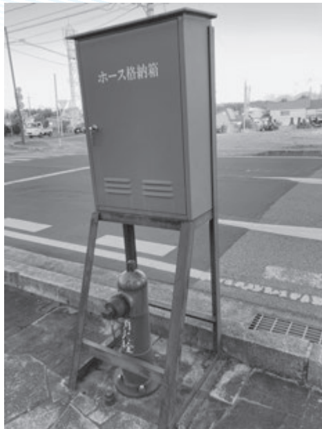
町内の消火栓と備品
