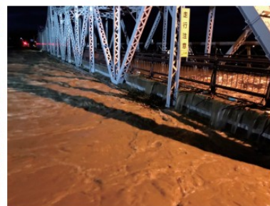
水位が橋の路面を越える (令和2年7月29日午前0時頃)
