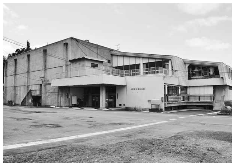
老朽化した福祉会館
